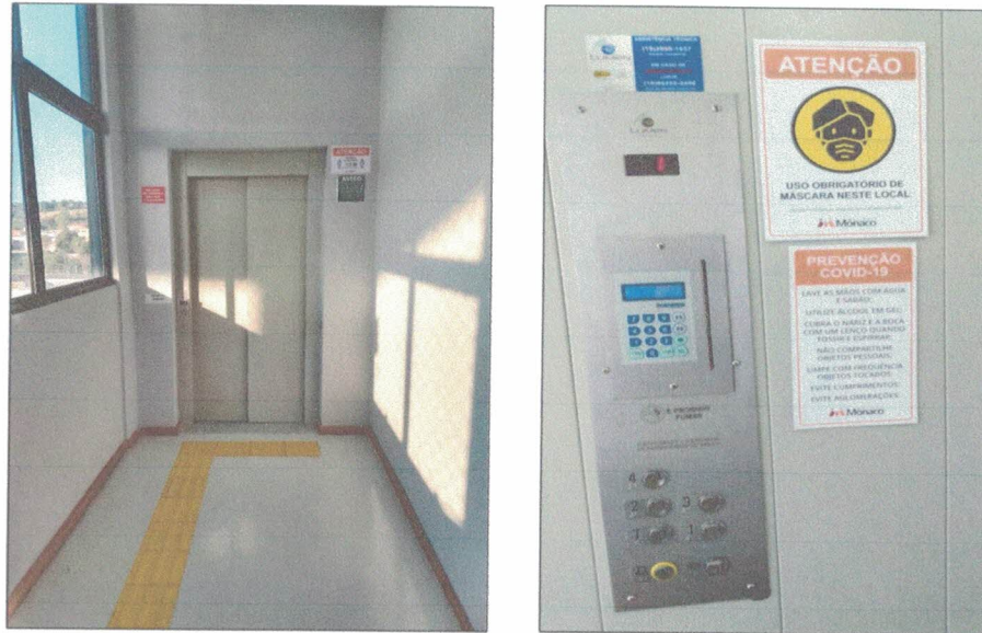
Imagem 5 - Elevador social (exterior e interior)
